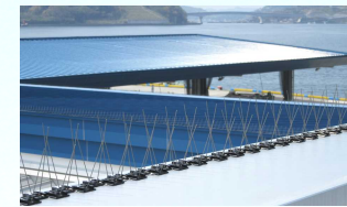
屋根に設置されたバードピン 鳥の着地を防止
